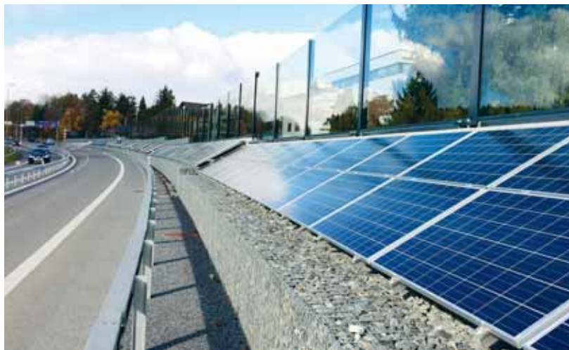
Im Oktober 2014 wurden an der Forchautostrasse in Zumikon auf 300 Metern Lärmschutzwand eine Photovoltaikanlage installiert. Der produzierte Strom kann den Jahresbedarf von 22 Haushalten abdecken. Quelle: TBA
