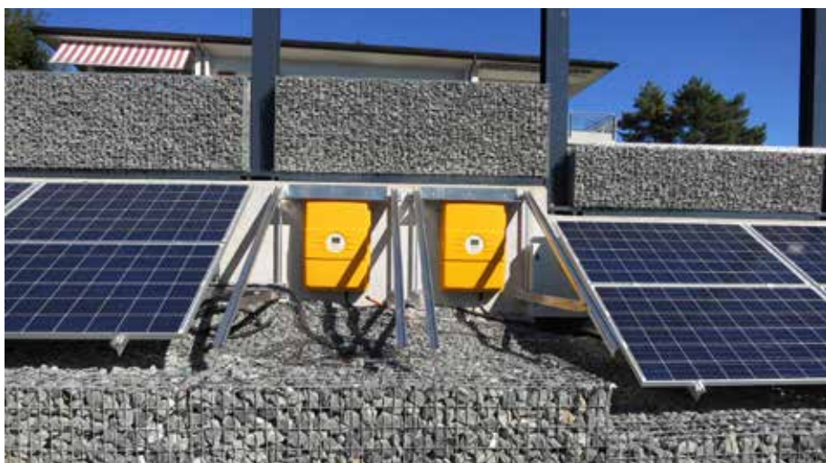
Die zwei Wechselrichter pro Abschnitt sind unterhalb der PV-Module angebracht.
