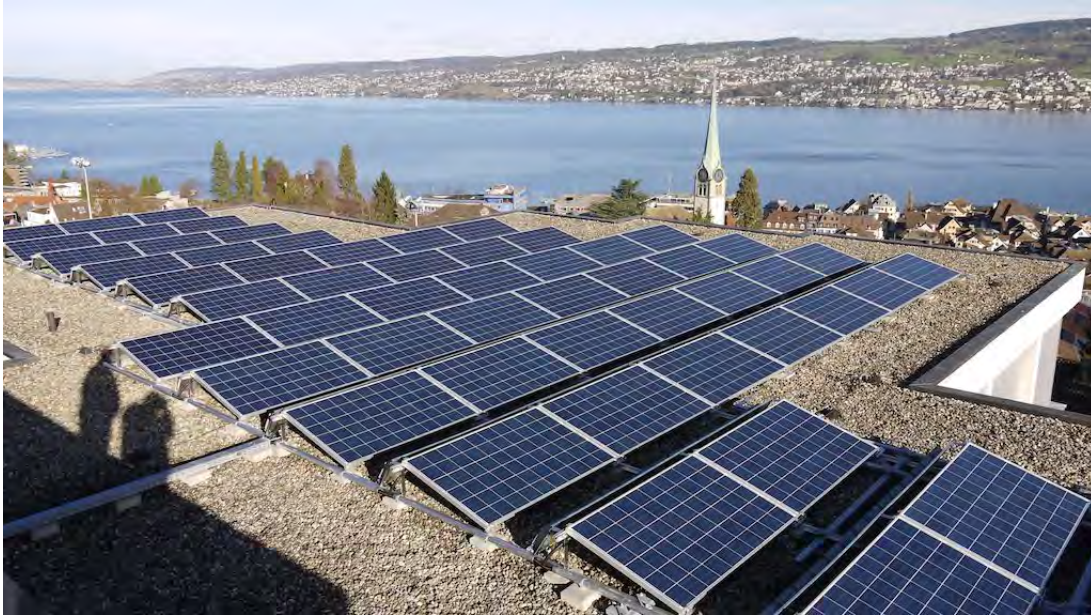
PV Anlage der Zürichsee Solarstrom AG auf dem Schulhaus Bergli in Horgen.
